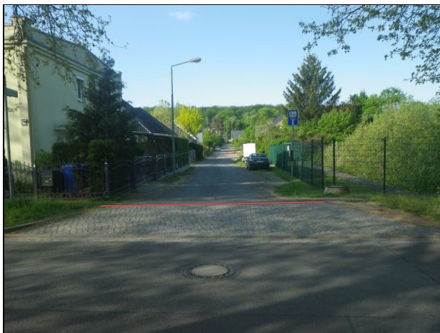
Foto 1: Gersthofweg in Potsdam, Beginn der Baumaßnahme am Übergang Kleinpflaster – Asphaltbefestigung (rote Linie = Station 0+000), Blick in Richtung Südwesten
